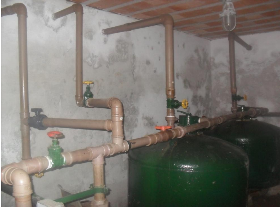
Figura 19- Filtros, registros de comando, bombas e visores de lavagem
