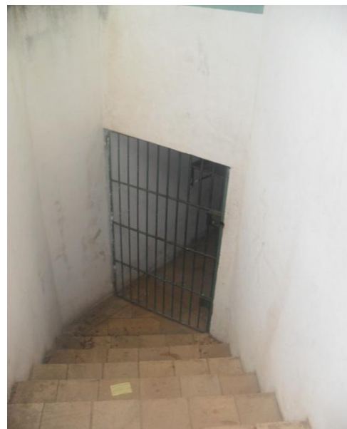
Figura 18- Entrada da casa de máquinas
